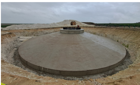
La fondation sera recouverte de terre. Le socle restera émergé, le mât de l'éolienne y sera boulonné. Poids de la fondation : 68,5 t. Diamètre du socle : 4,4 m
